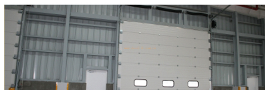
Automatic rolling shutter door
